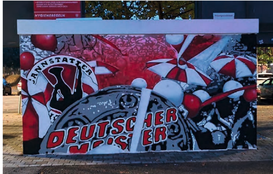
Bild: Strom-Station in Bad Cannstatt
